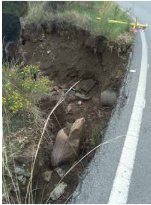
Daños en la carretera y obra de fábrica (P.K. 1+570)
